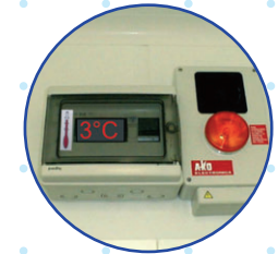
Surveillance des températures
